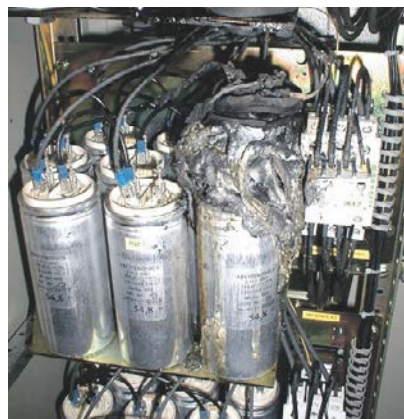
Abb. 6: Zerstörter PP-Blindleistungs-Kompensationskondensator: Ein schleichender hochohmiger Masseschluss hat zum kompletten Aufschmelzen des Kondensators und einem lokalen Brandherd geführt.
