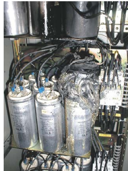
Abb.: Zerstörte Kondensatoren durch Oberschwingungen
