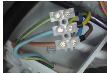
Abb. 7: Hier wurden N- und PE vertauscht
